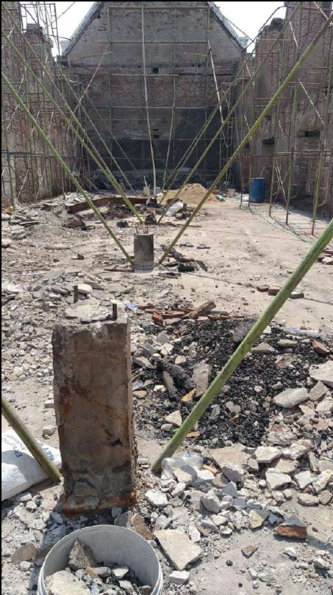
SEMUA KOLOM SUDAH PERNAH DIGANTI DENGAN BETON
